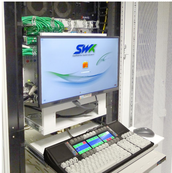
Systemraum mit Bedienkonsole
