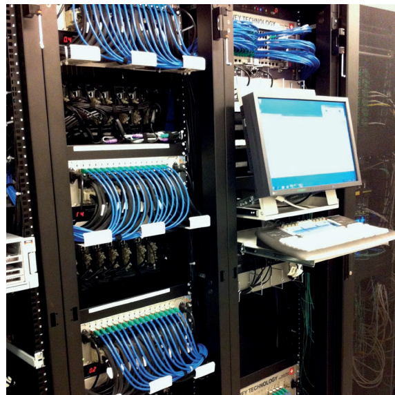
Vattenfalls system room
